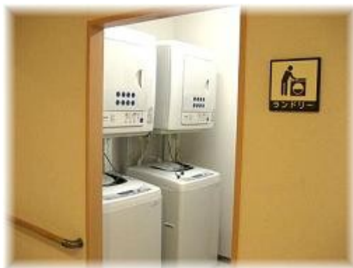
洗面・トイレ・ランドリーの様子
