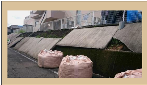
保健福祉センター横のフェンス下土台部分の被害状況
